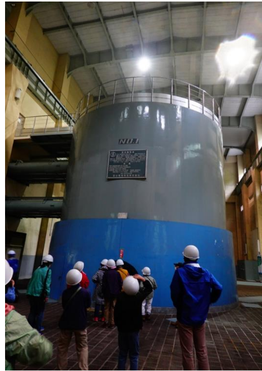
和田川第二発電所内に2機の水車発電機があります。
